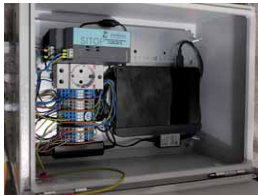
Steuerungszentrale für das Klima in der Gruft
